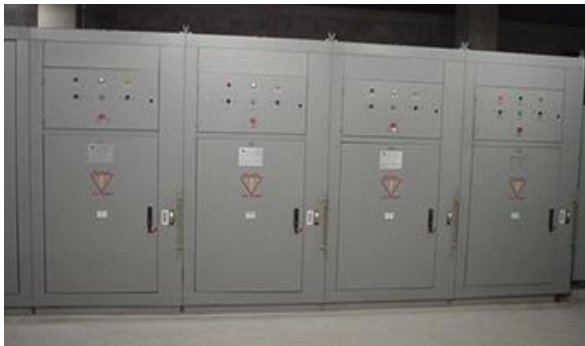
Banco de capacitores en media tensión. Proyecto Gran Canal (diseñado por el Dr. Ing. Alfredo Navarro Crespo).
