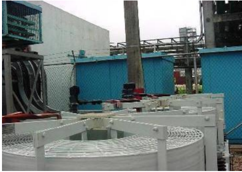
Reactores limitadores de corriente, núcleo de aire. (diseñados por el Dr. Ing. Alfredo Navarro Crespo).
